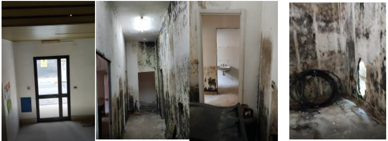
Figura 8 –ex Casa della Solidarietà – Piano terra in dx completamente da ristrutturare
